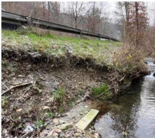
Bild 11: Erosion Hessentaler Straße
