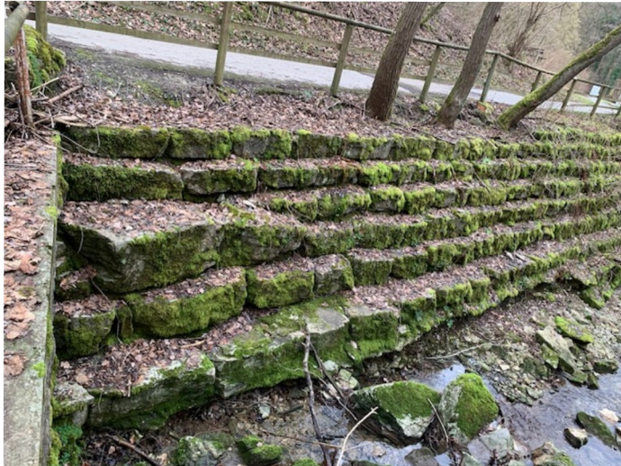
Bild 17: Unterspülungen Fundament Verbau
