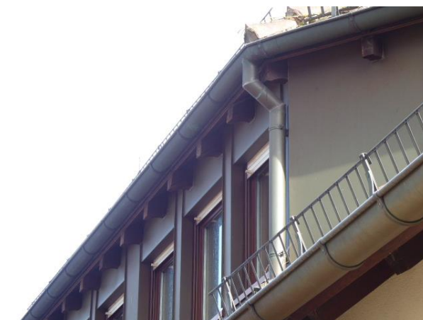
Abb. 12: Dachvorsprung des Gebäudes Gräterweg 12/1 ohne Nistgelegenheiten für Vögel.
