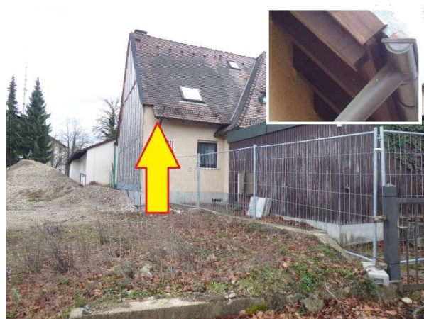
Abb. 10: Dachvorsprung des Gebäudes Gräterweg 12/1 ohne Nistgelegenheiten für Vögel.
