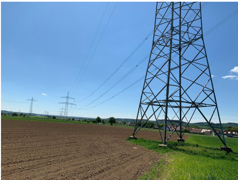
Abb. 2: 380-kV-Freileitung rechts mit 110-kV-Freileitung (links)
